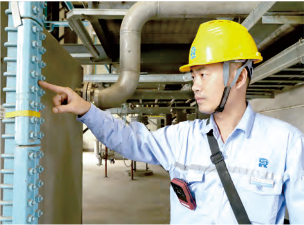
▲ 阆中双瑞对C301冷剂压缩机润滑油实施在线过滤，有效延长润滑油使用寿命，保障机组长周期稳定运行，节约润滑油更换费用约24万元。
